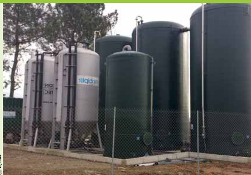
Station de traitement des lixiviats
