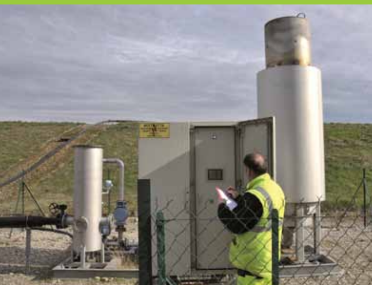
Station de traitement du biogaz
